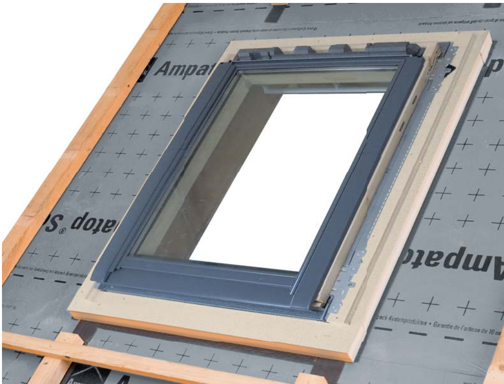
Fenster samt VELUX Wärmedämmrahmen in der PUREN-Zarge
